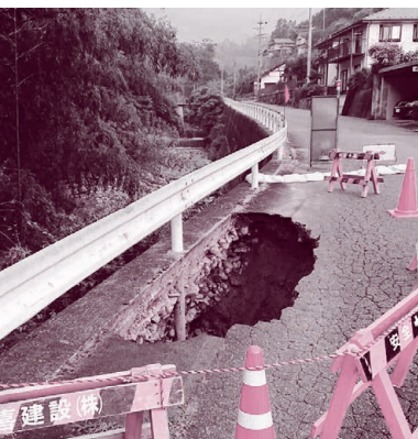
毛賀沢川沿いでも陥没
