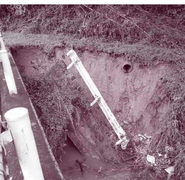
毛賀沢川での擁壁とガードレールの崩落
